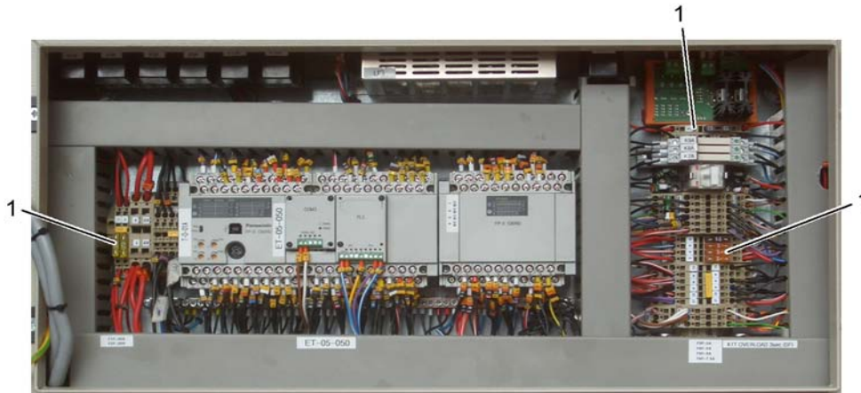
Compartiment électrique, ouvert
